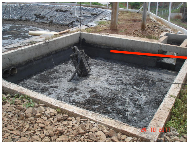
Armazenamento de Dejetos da Granja
